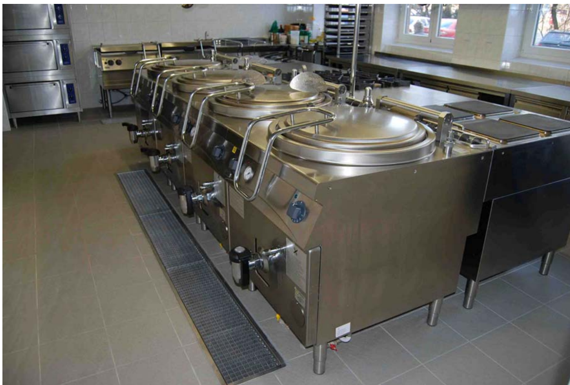
Obr. 3 Varný kotel (zdroj: fotoarchiv autorky)
