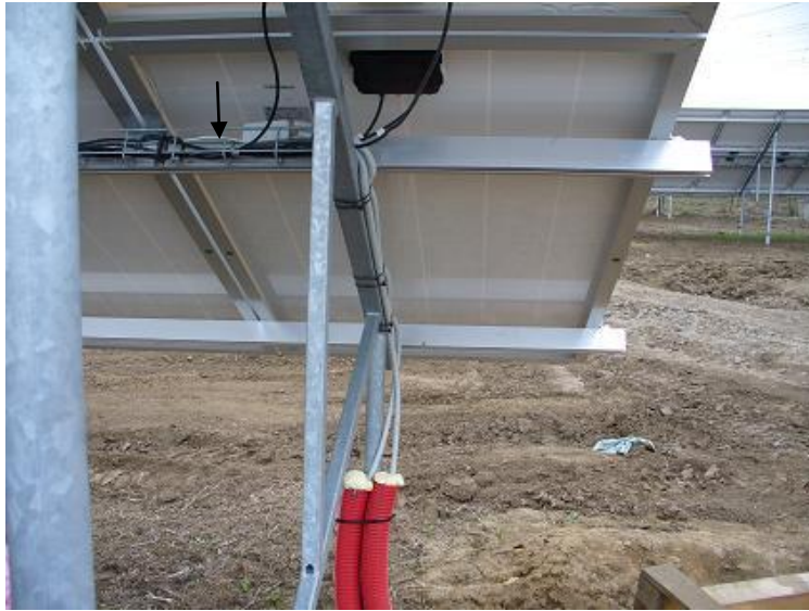
Obr. 29. Hlídané vedení (bílé)
