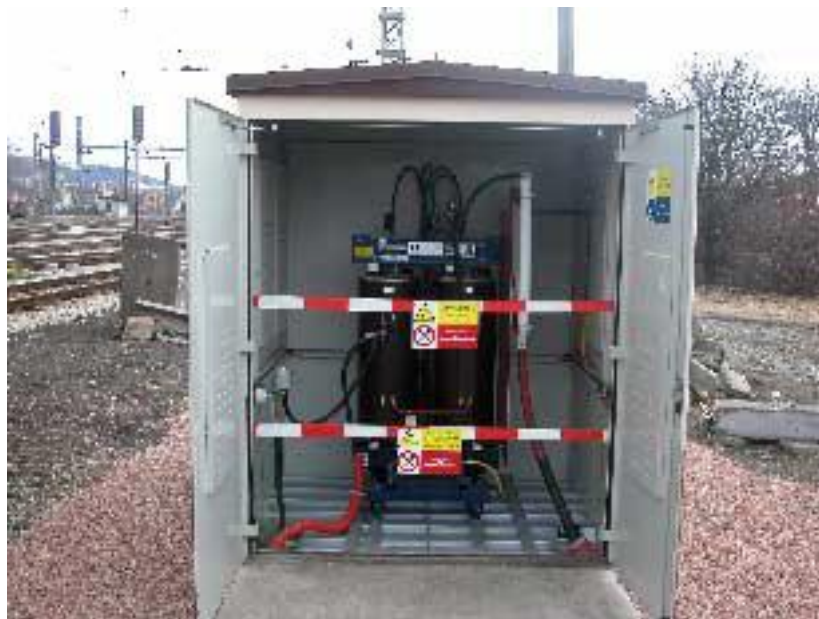
Obr. 7. Napájení z trakčního vedení 25 kV AC 50 Hz.
