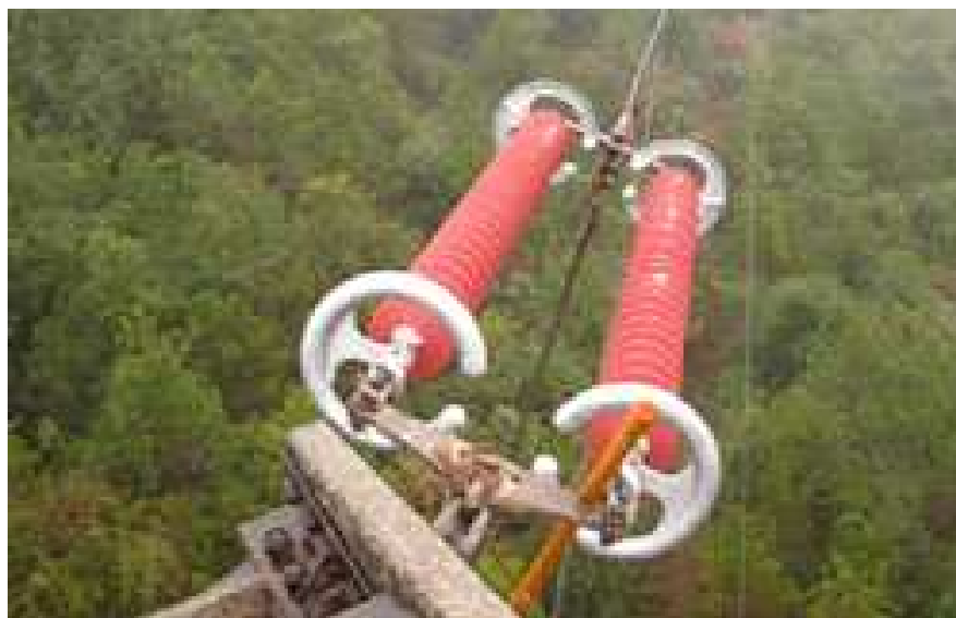
Obr. 29. Kompozitní izolant vysokého vedení [22]
