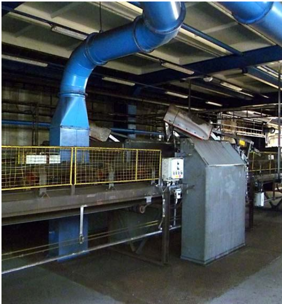
Obr. 25. Odsávání přetlaku z bunkrů
