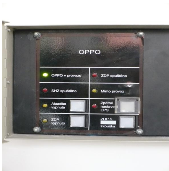
Obr. 9. Obslužný panel požární ochrany.
