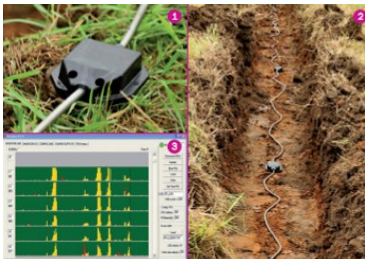
Obr. 20 Podzemní detekční perimetrický systém Underground. [15]
