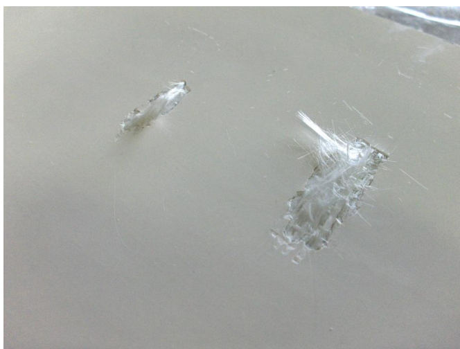
Obrázek 51 Detail na poškození součásti
