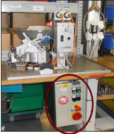
Obrázek 25 Ukázka rozvodové bedny umístěné pod pracovní plochou (Zdroj: vlastní zpracování)
