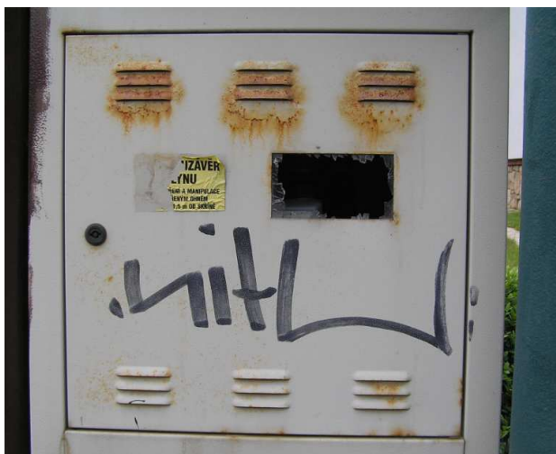
Obr. 12: Poškozené dvířka od HUP
