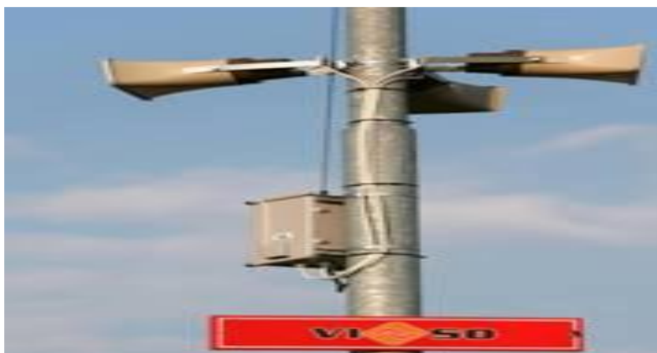
Obrázek 7 Bezdrátový hlásič umístěný na sloupu veřejného osvětlení
