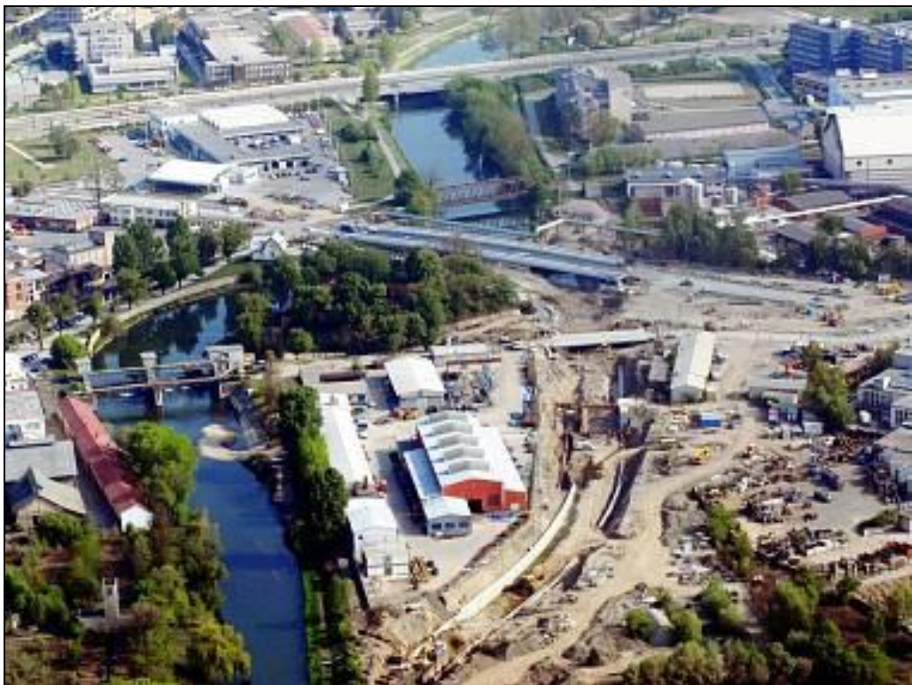
Obrázek č. 7 – Začátek výstavby obtokového kanálu v průtoku Salzerovy reduty u Olomoucké teplárny [19]
