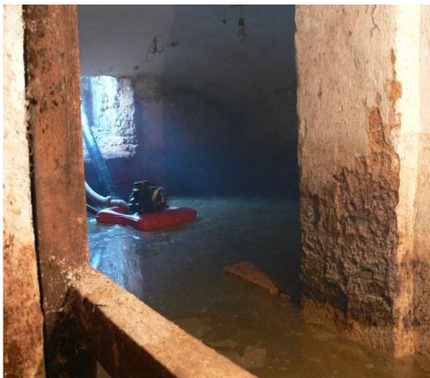
Obrázek 10: Odčerpávání vody ze sklepa
