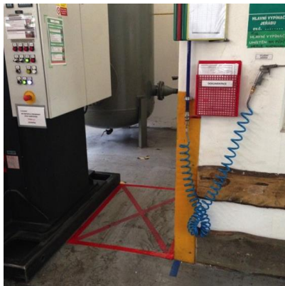
Obr. 45 Ukázka označení místa před elektrorozvaděčem pece (Zdroj: vlastní zpracování)
