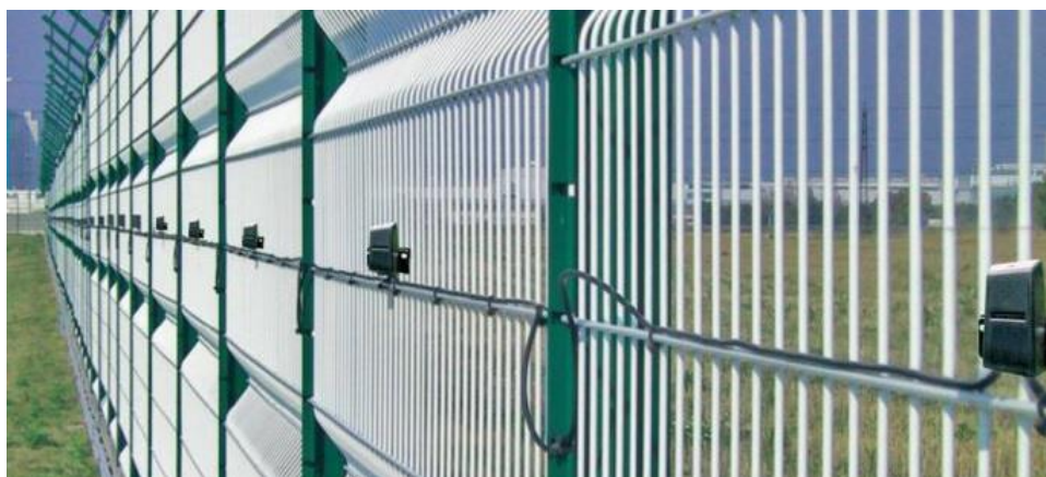
Obr. 5. Detekční systém perimetrické ochrany [Zdroj: 4]
