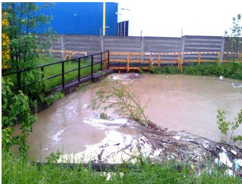
Obrázek 14: Ucpaný jeden z mostů vedle areálu SCHOTT, kterým protéká Krhovský potok
