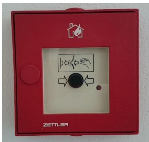
Obrázek 14 Tlačítkové hlásiče jsou typu TL-1 [Zdroj: autorka]
