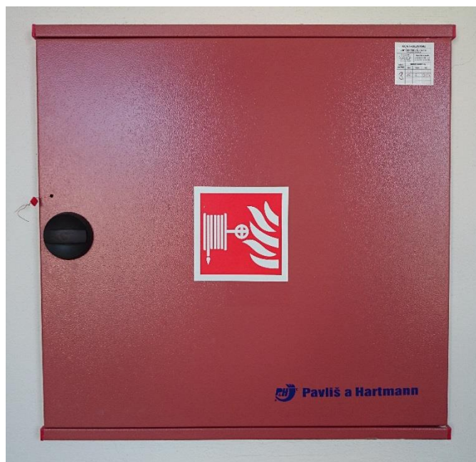
Obrázek 16 Nástěnný požární hydrant
