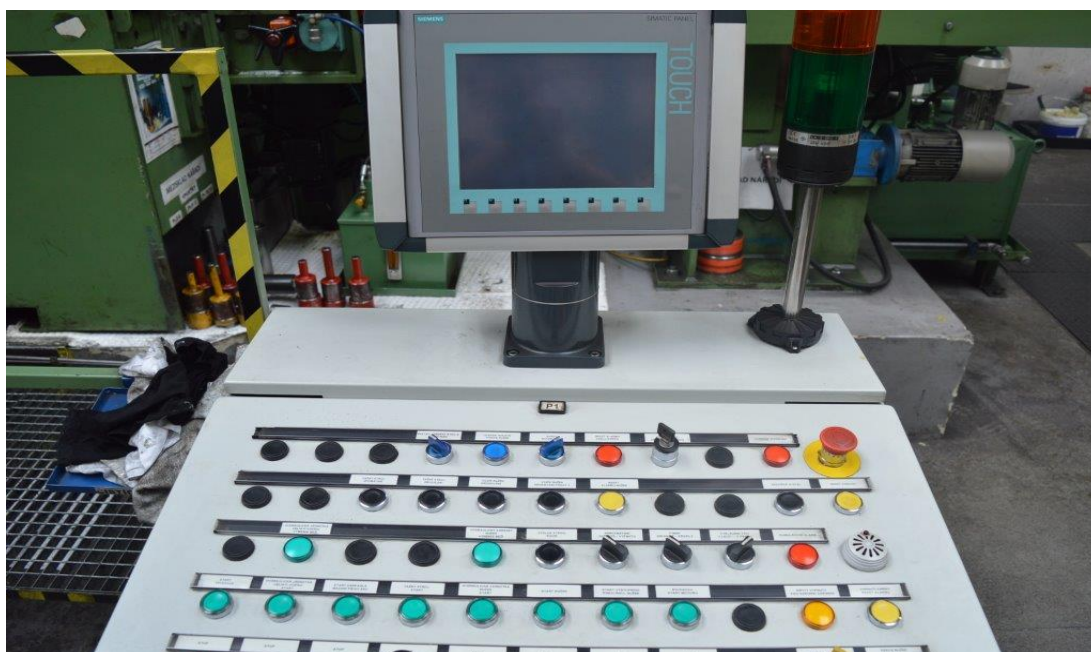
Obrázek 6: Řídicí panel systému Simatic (vlastní zpracování)
