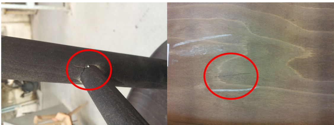
Praskliny ve spojích
