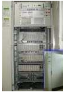
Obr. 14. Zabezpečovací zařízení ELEKSA 93 [18]
