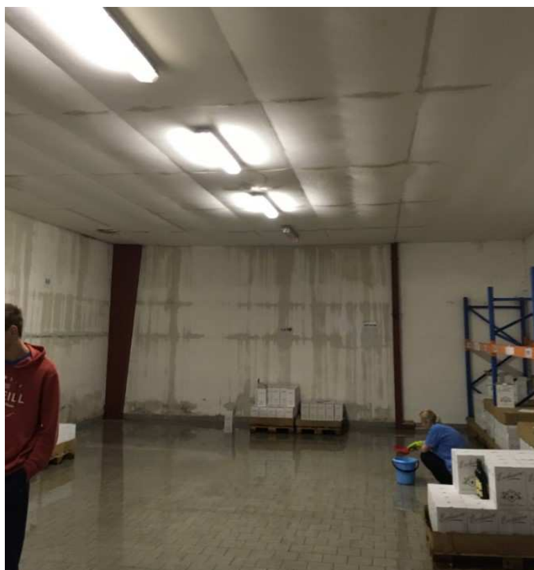
Obr. 7. Prostor zatopeného skladu.
