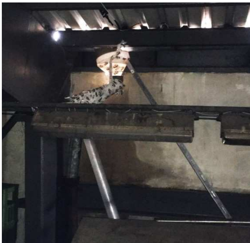
Obr. 5. Improvizovaná oprava svodu.
