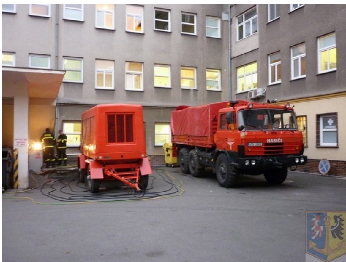
Obr. 12. Připojení mobilní elektrocentrály na budovu. Zdroj: převzato z [29]
