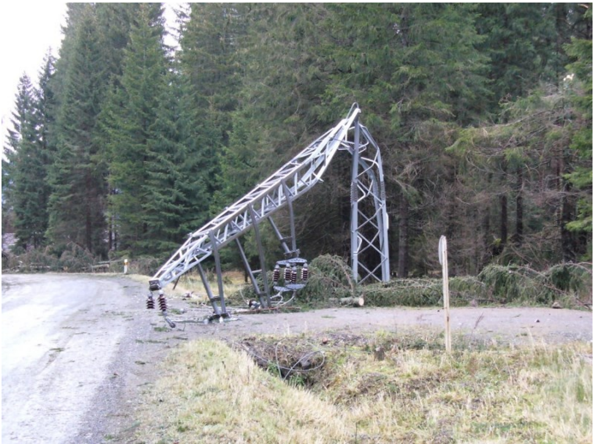
Obr. 8. Následky Orkánu Kyrill. Zdroj: Archiv ČEZ [16]
