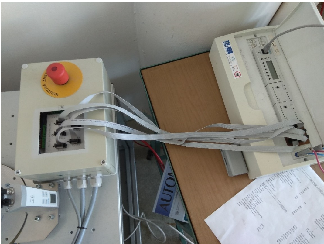
Obrázek 61 Připojené (neukotvené) komunikační rozhraní k PLC Foxtrot
