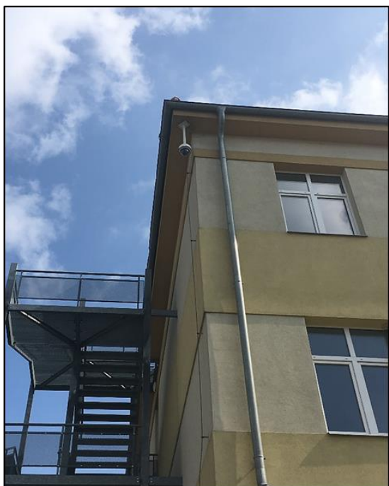
Obr. 2 Vnější kamerový systém na budově UH4
