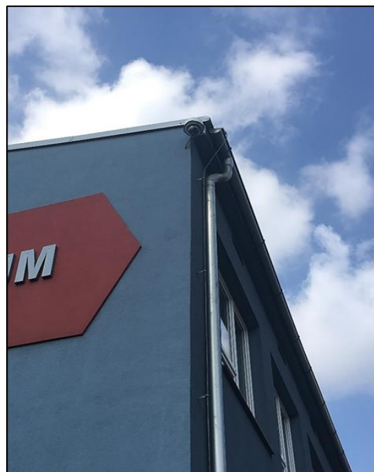
Obr. 3 Vnější kamerový systém na budově UH2
