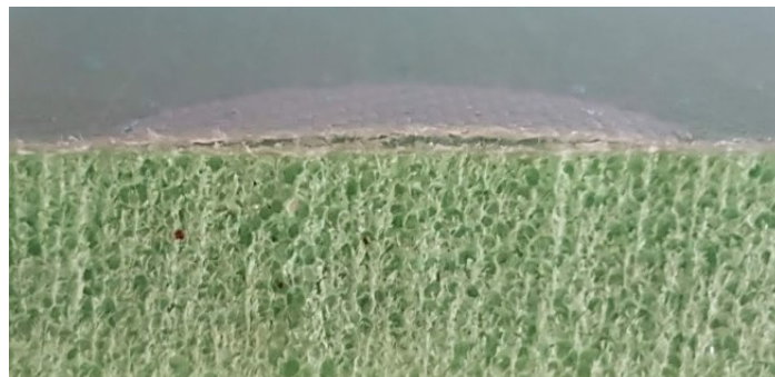
Obr. 49 Detail delaminace potahové vrstvy od jádra sendviče
