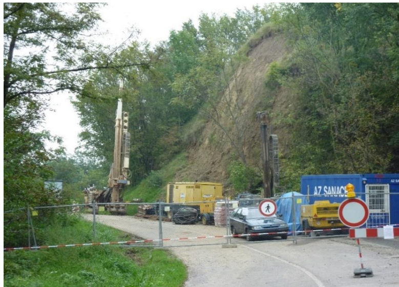
Obr. 15 Sesunutý svah nad komunikací v Dolních Věstonicích, zdroj vlastní
