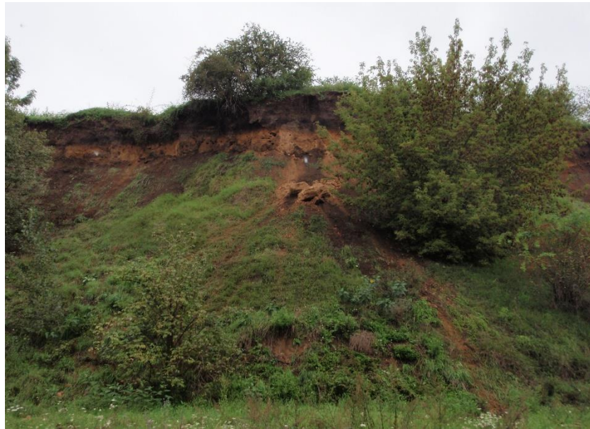
Obr. 11 Utržení svahu, Strachotín, zdroj vlastní
