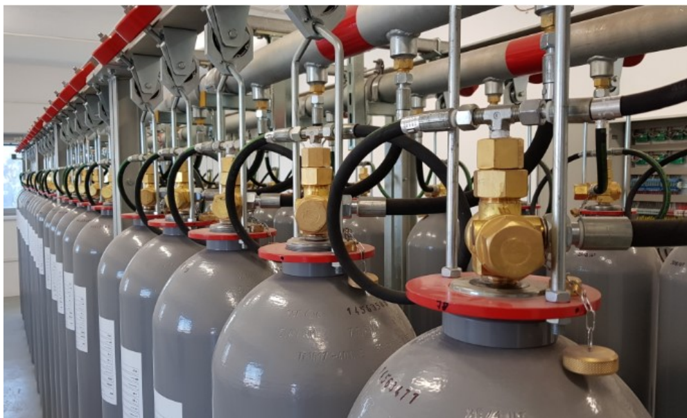
Obr. 8. Strojovna hašení CO 2 [vlastní]
