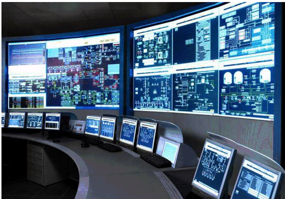
Obrázek 18 Přístroje pro virtuální instrumentaci – SCADA monitoring center [14]
