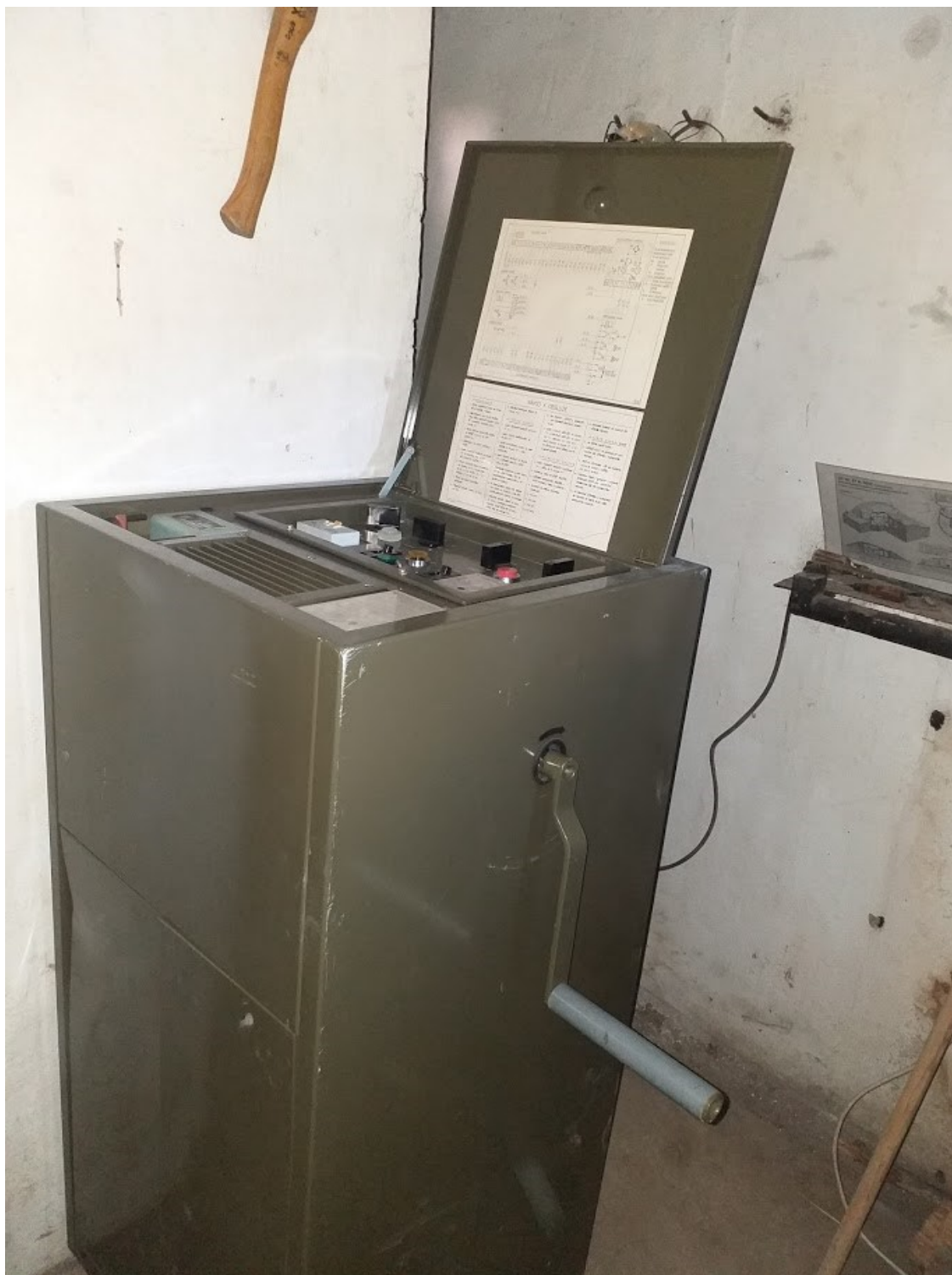
Obrázek 25 Umístění FVZ-150 v objektu (Autor, 2021)
