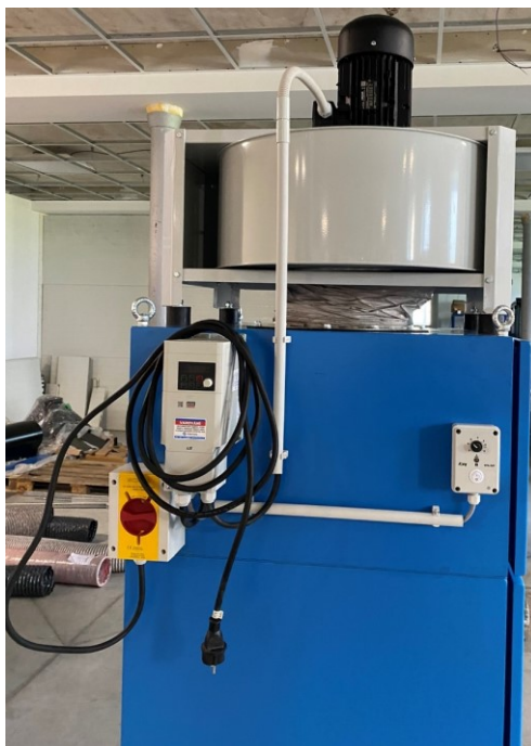
Obr. 74 Elektroinstalace filtračního zařízení
