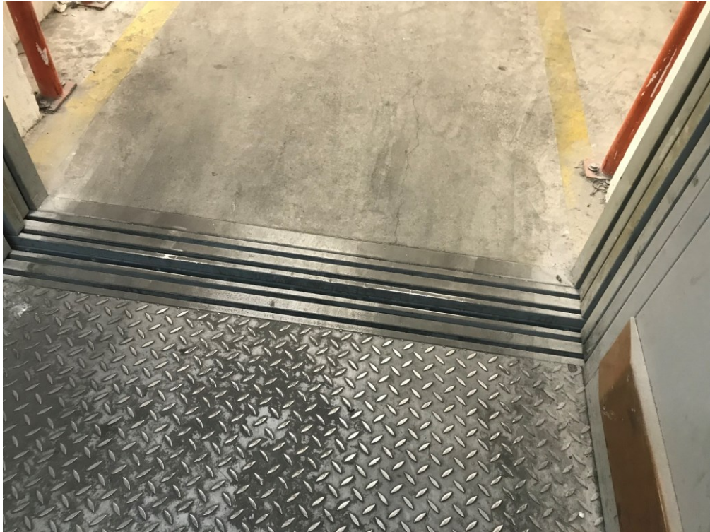
Obrázek 13 Chybné dojetí výtahu (Vlastní zpracování)
