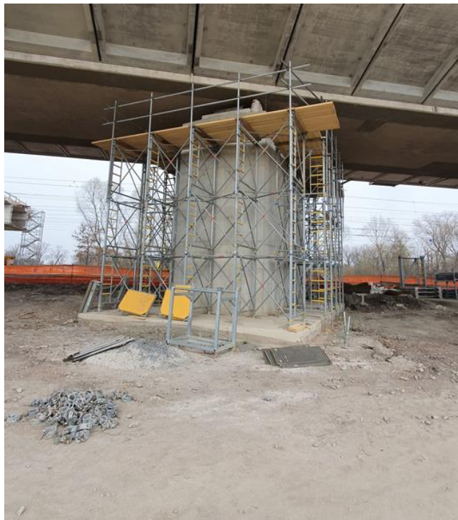
Obrázek 20 Neuklizený materiál na konstrukci lešení a chybějící zajištění na lešení proti pádu materiálu
