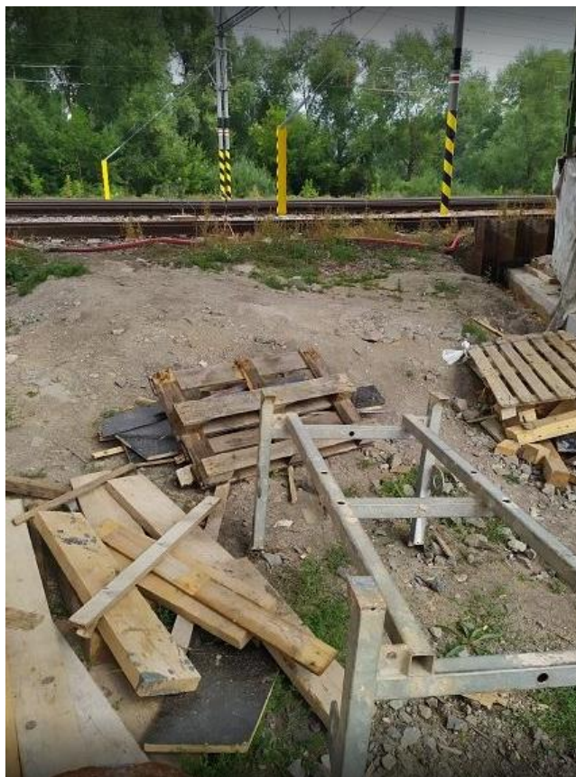
Obrázek 22 Neuklizené dřevo po odbednění
