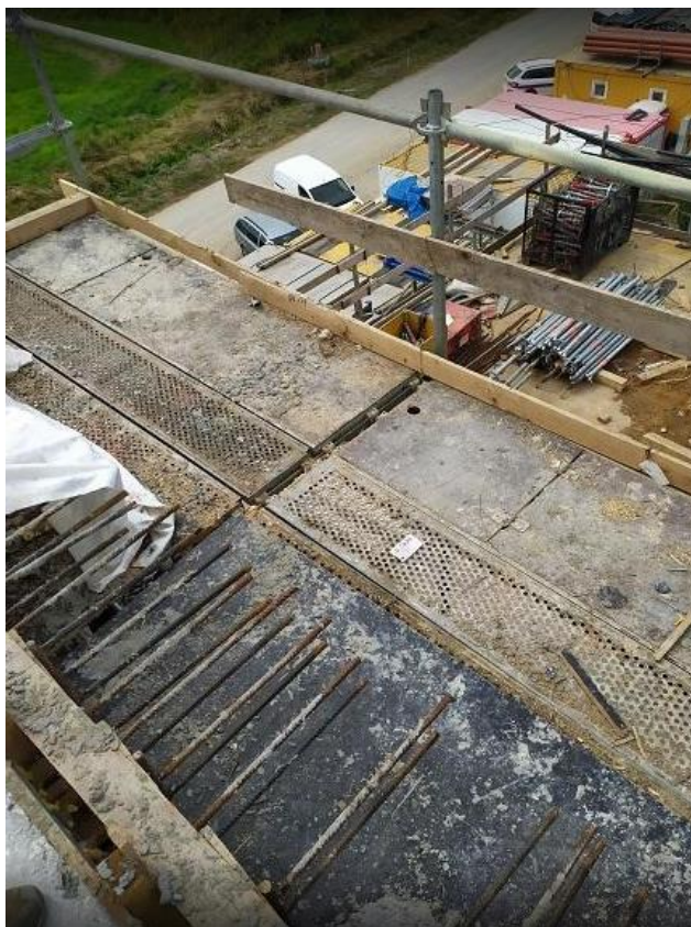
Obrázek 19 Chybějící střední část zábradlí na lešení
