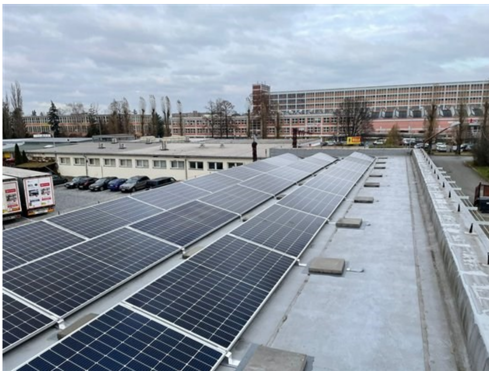
Obrázek 10 Fotovoltaické panely na střechě budovy TEHOS, s. r. o. (zdroj: Město Otrokovice, © 2023)
