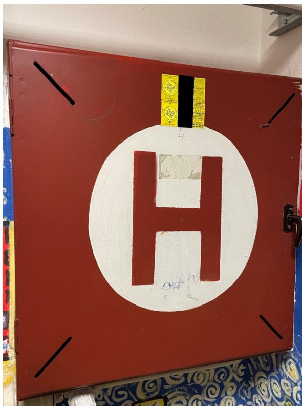
Obr. 13. Hydrantová skříň ve škole [vlastní]
