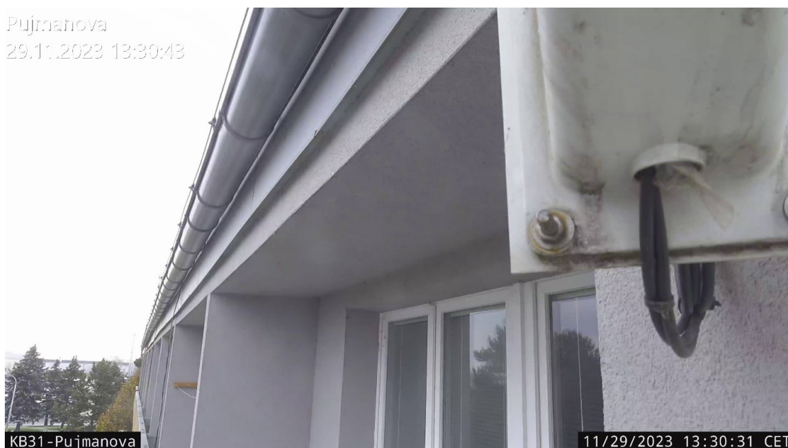
Obrázek 15 Nevhodný záběr IP PTZ kamery 2
