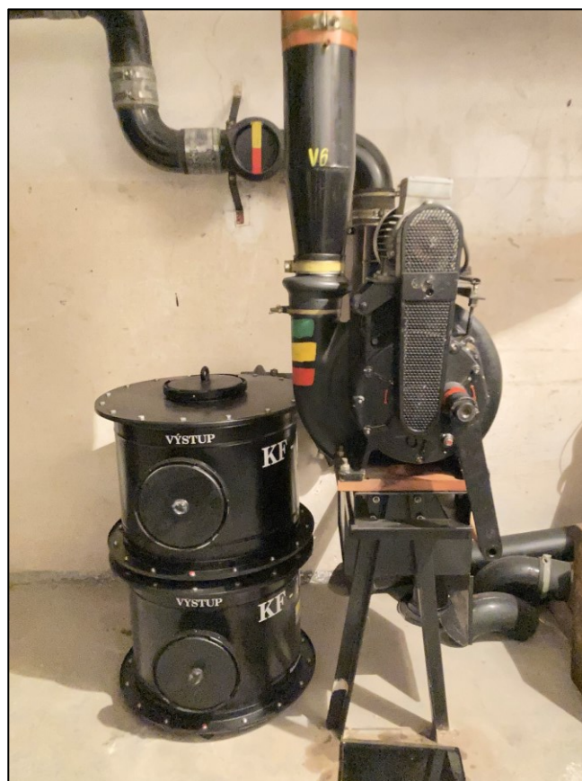
Obrázek 10: Čerpadlo s radiálním ventilátorem (vlastní)
