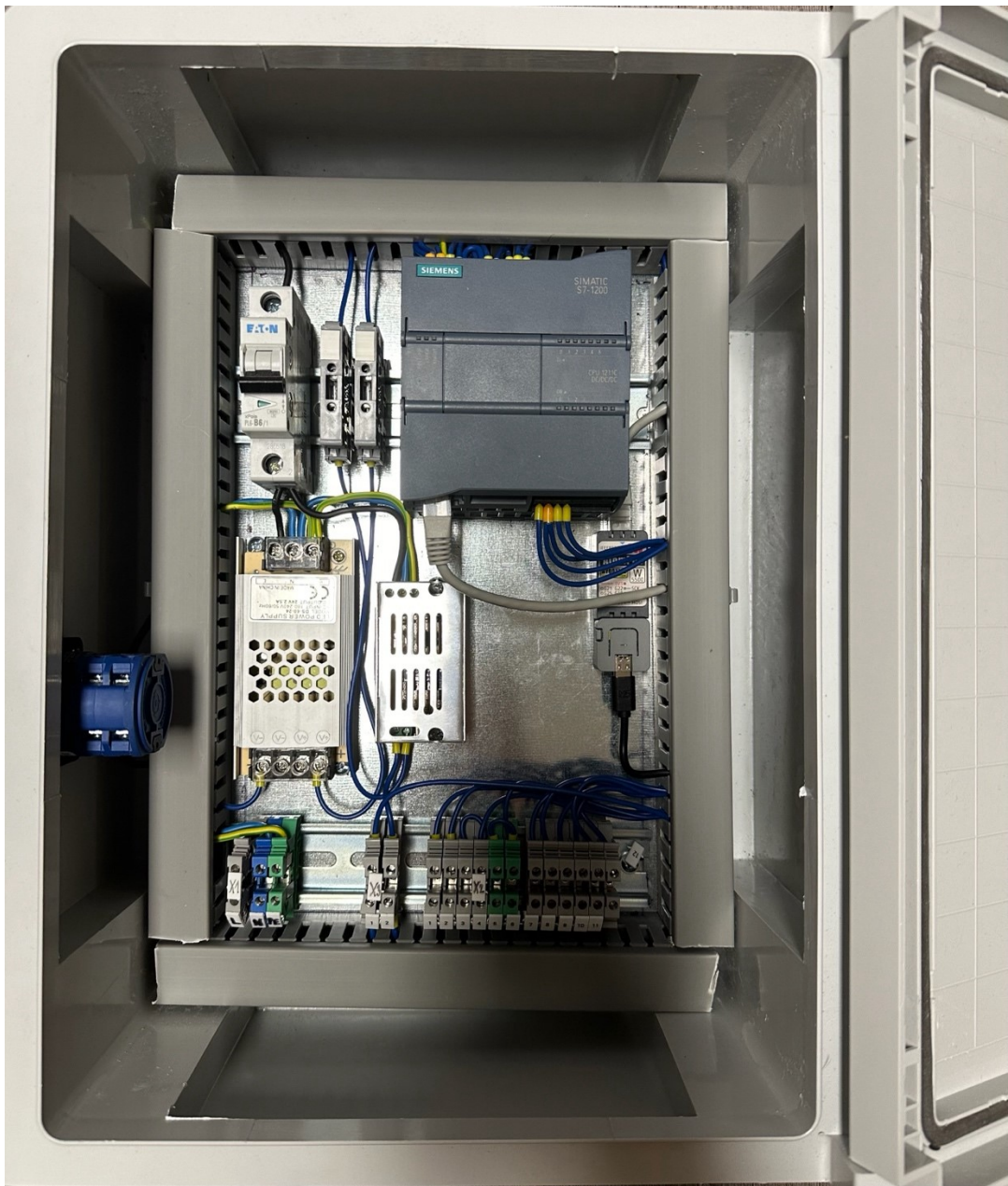
Obrázek 26: Zapojený řídicí rozvaděč
