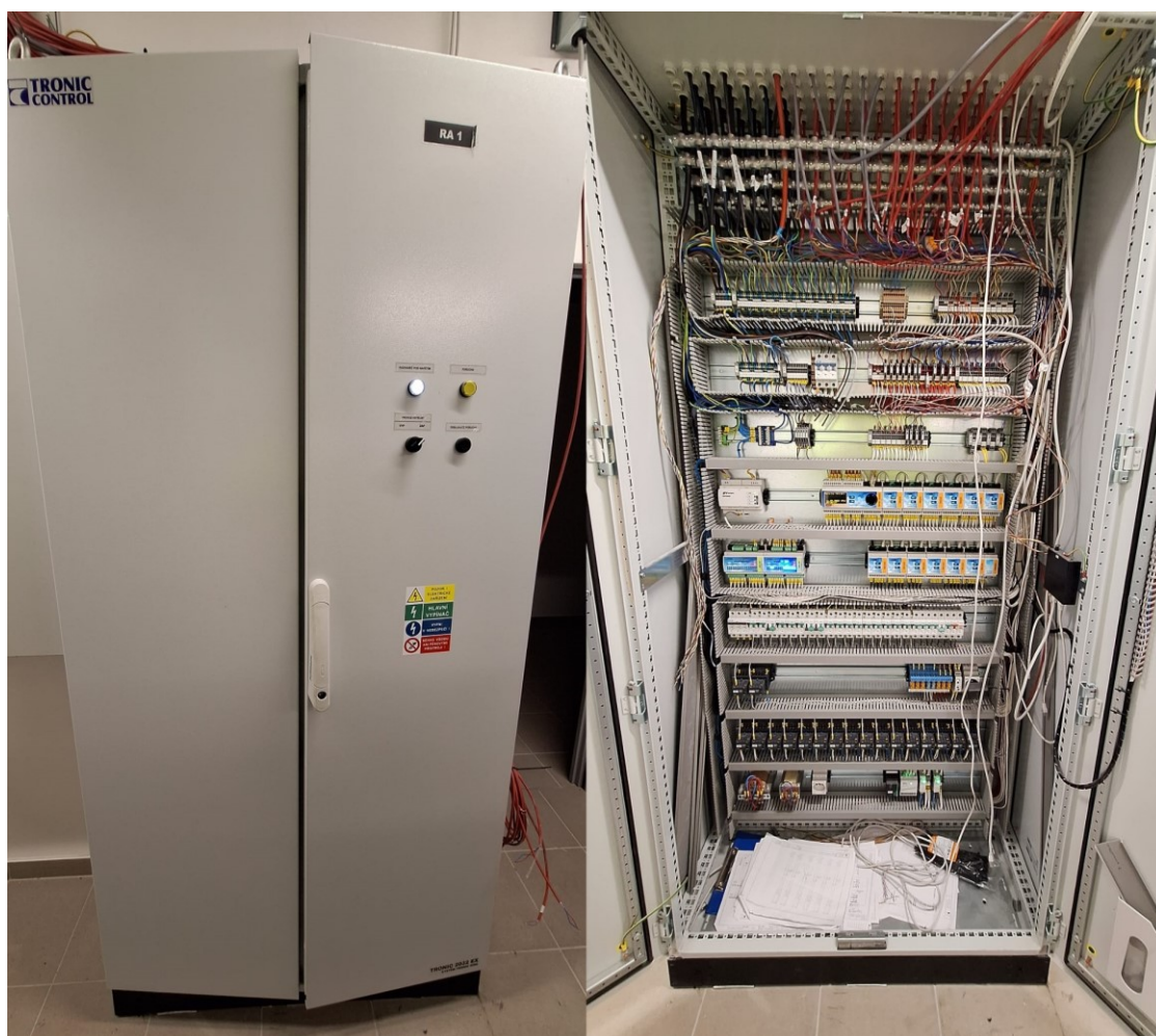
Obrázek 25 Realizace rozvaděče RA1 s řídicím systémem pro kotelnu a větrání [1]
