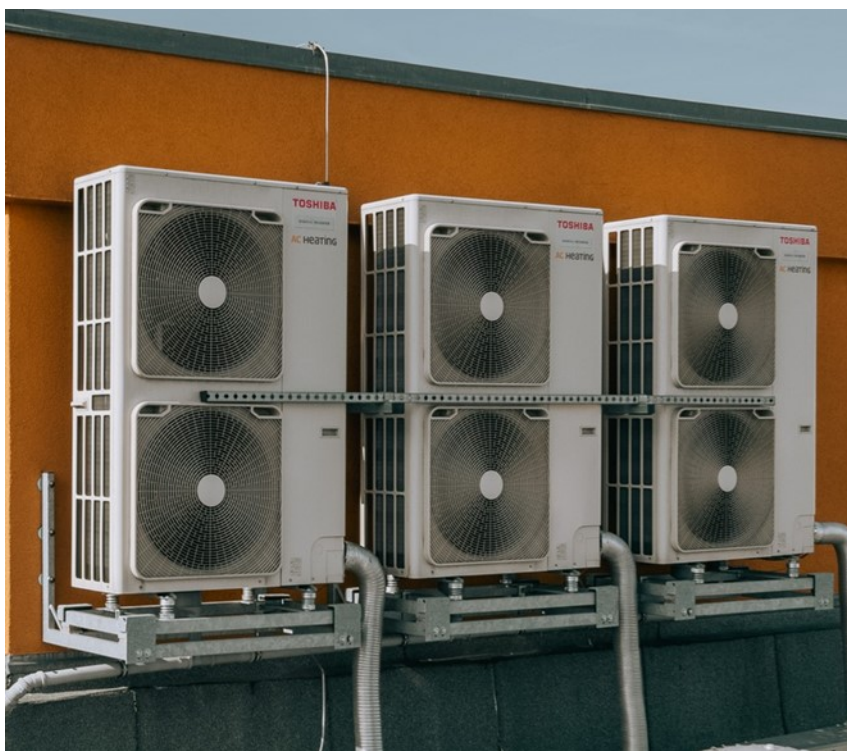
Obrázek 2 Venkovní jednotky tepelných čerpadel Toshiba [9]
