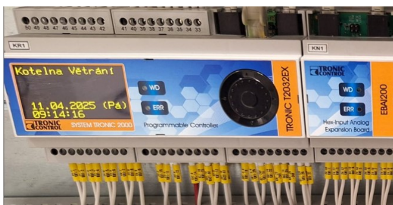
Obrázek 110 Terminál řídicího systému T2032EX v rozvaděči RA1 [1]
