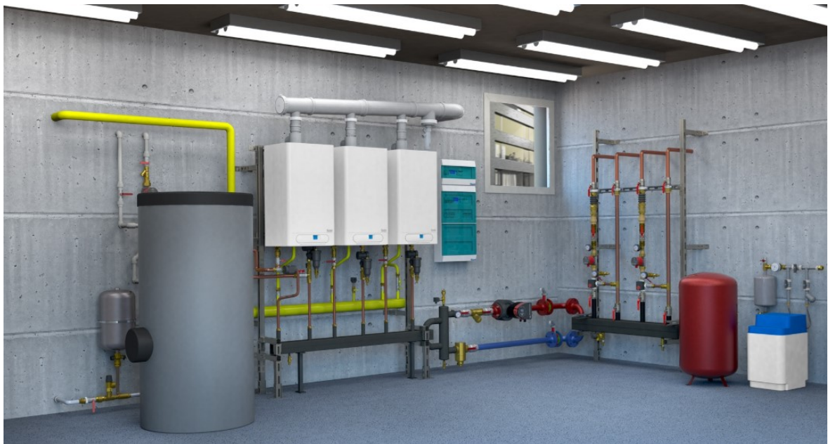
Obrázek 1 Plynová kotelna s kaskádou tří kotlů [7]
