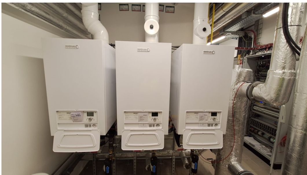
Obrázek 52 Kaskáda kotlů Brojte Heizung[1]
