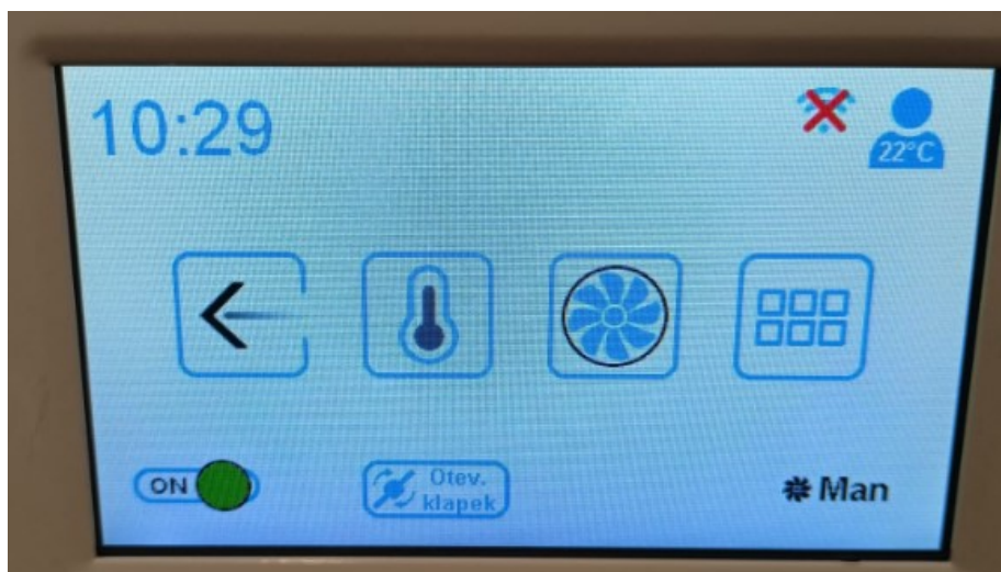
Obrázek 101 Terminál vzduchotechnické jednotky se stavem ZAPNUTO[1]
