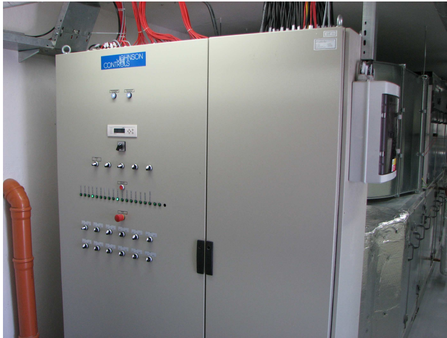
Obrázek 31 : Fotografie rozváděče řídicího systému ve strojovně budovy
