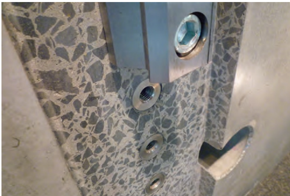
Obr. 32. Detail obrobené (broušené) plochy a vlepených ocelových závito- vých pouzder pod lineární vedení. [13]
