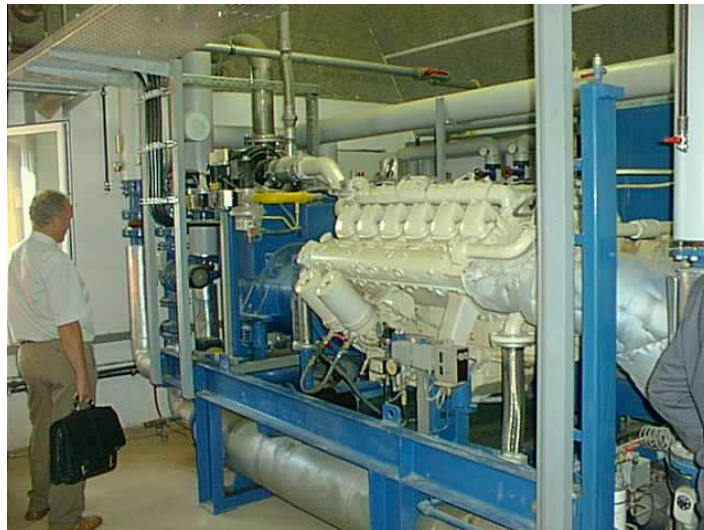
Obr.6. Kogenerační jednotka na BPS Phalheim [28].
