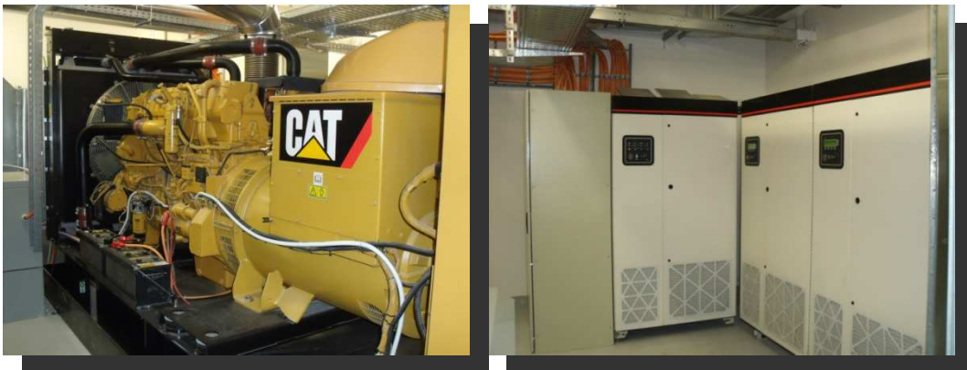
Obr. 14, 15 Technologie nepřetržitého, bezvýpadkového napájení
