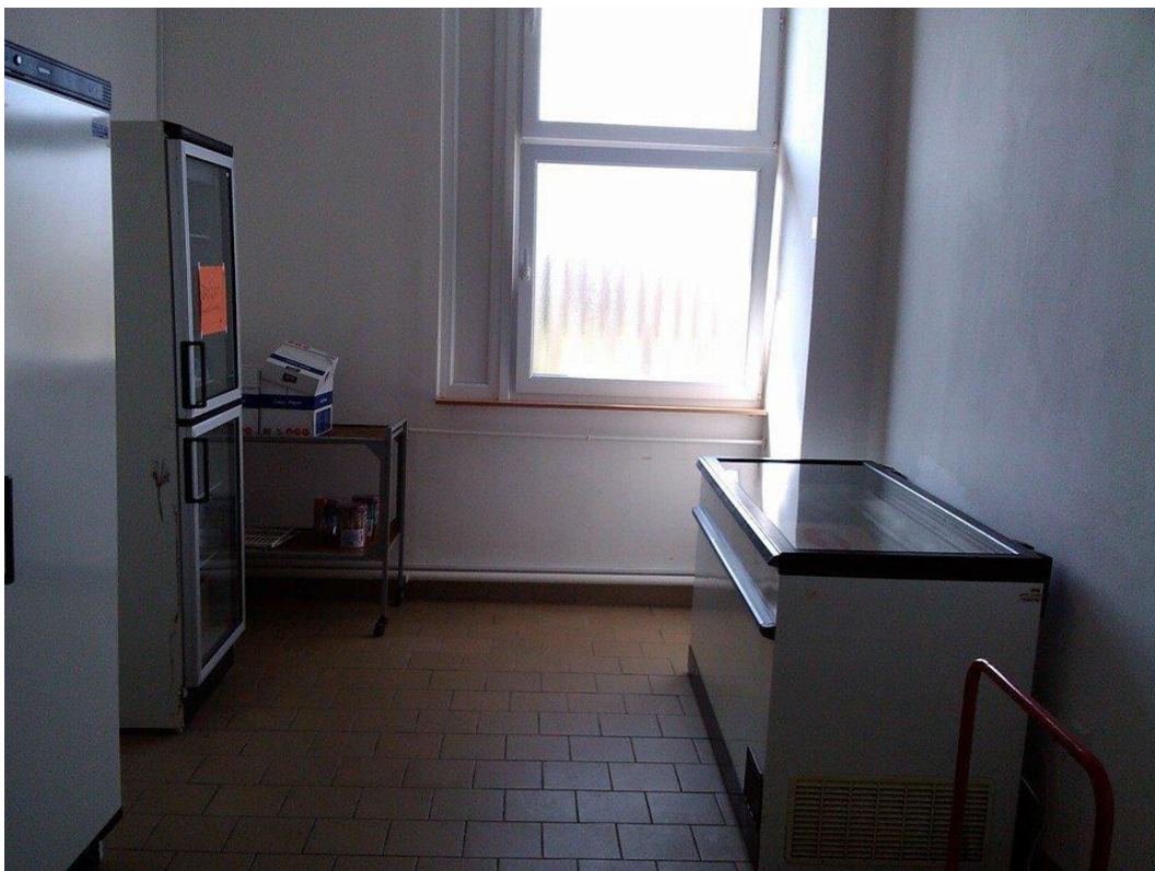
Obr. 9 Chladicí zařízení kuchyně [zdroj vlastní, 2014]
