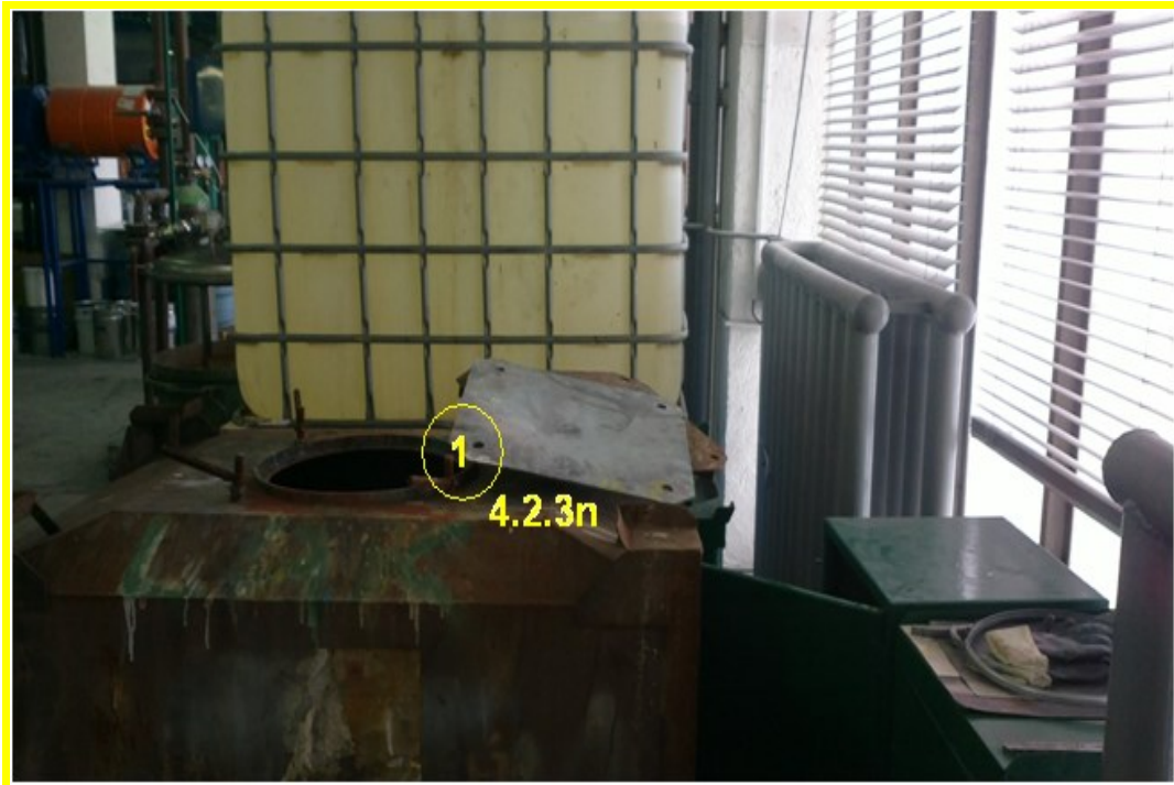
obrázek 7: Nebezpečí na pracovišti. Zdroj [vlastní]
