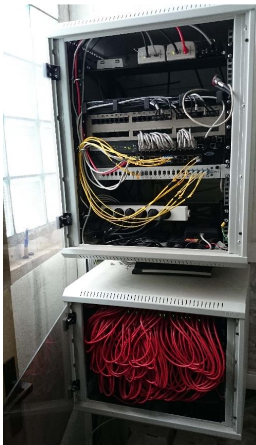
Obr. 19. Rack Dubina a rack sítě LAN.
