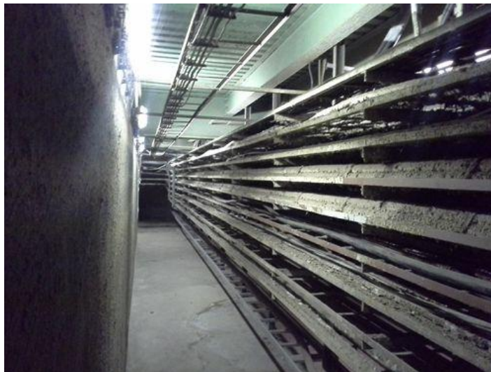
Obr. 13. Kabelový prostor -3m.
