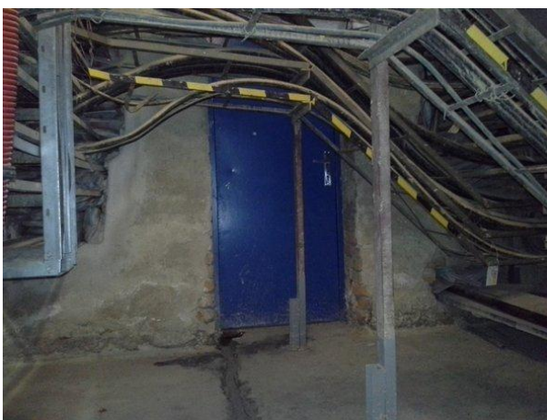
Obr. 14. Nevhodně umístěné kabelové vedení.
