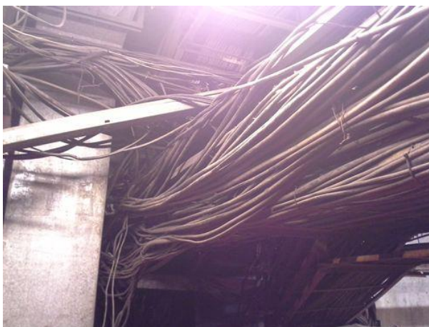
Obr. 10. Chybné uložení kabelového vedení.
