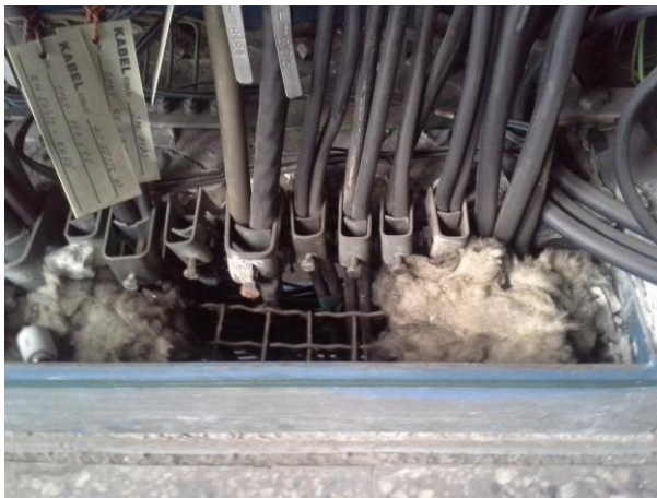
Obr. 24. Špatné provedení požární ucpávky.
