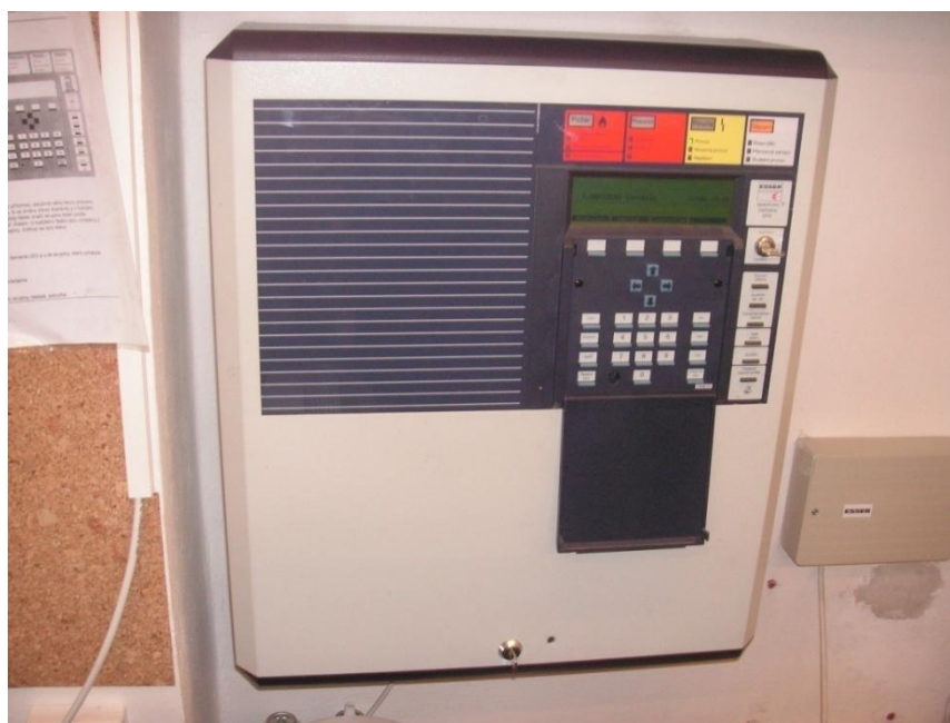
Obr. 3 - ústředna elektrické požární signalizace
