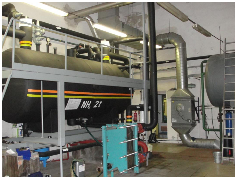
Obr. 7. Strojovna chlazení zimního stadionu [33]
