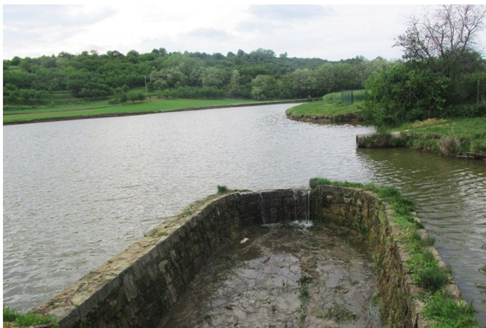
Obr. 5 Zabahněný bezpečnostní přepad na vodní nádrži Dolní Ježov [vlastní]
