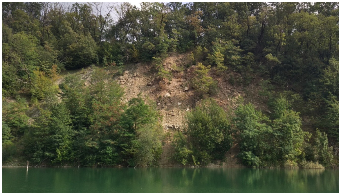
Příloha 9 - stěna s rizikem sesuvu (D. Zapletal)
